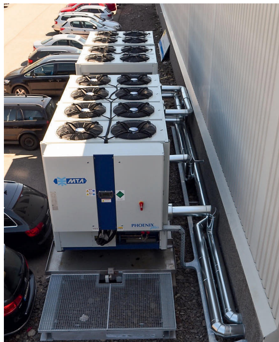
Durch zwei Kältekreisläufe und zugeschaltete Freikühlmodule wird 80 Prozent des Jahres eine Redundanz erzeugt. Bild: HSS
