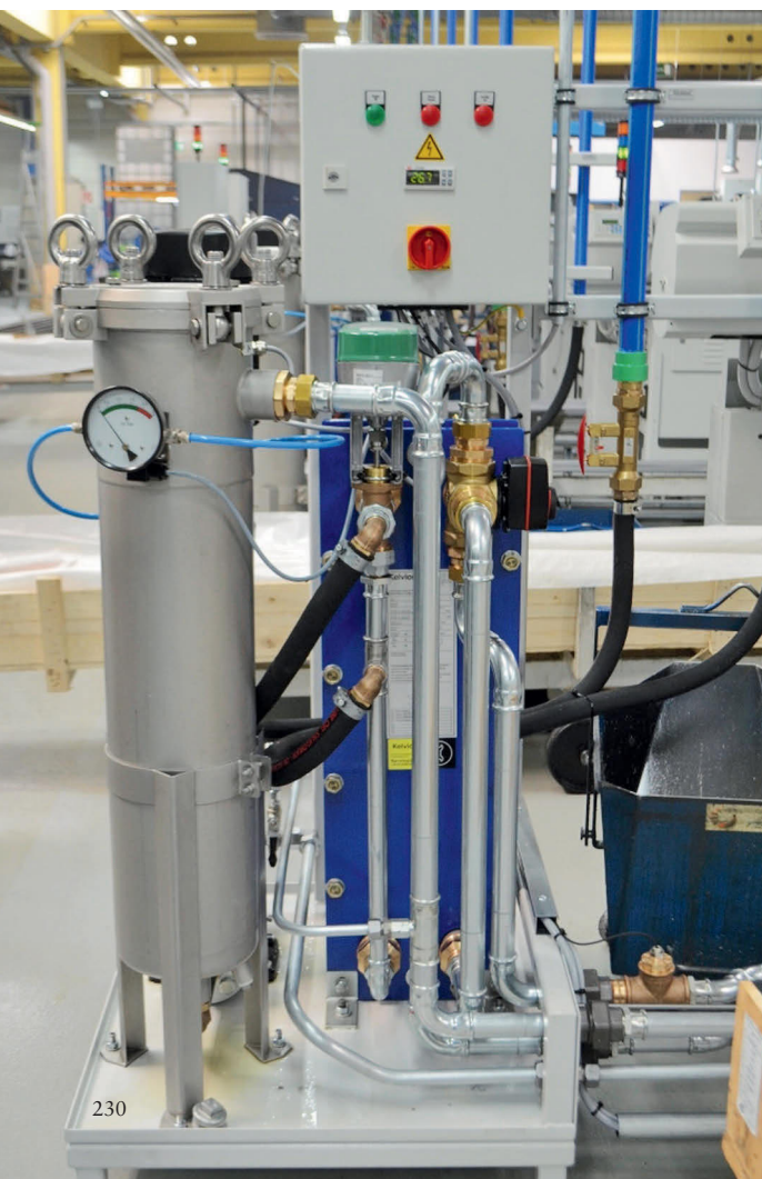
Kühlmittelaufbereitung mit Rückkühlung über Plattenwärmetauscher.
