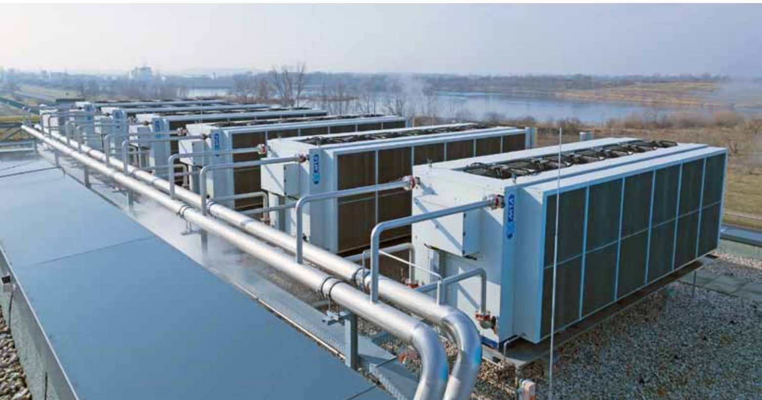
2,5 MW Kühlwasser-Rückkühlung mit „Airbatic“
