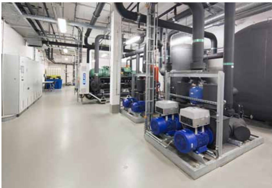
Von rechts nach links: Schichtenspeicher, Pumpenstationen, Kältemaschinen „AQP 2502“ und Schaltschrank
